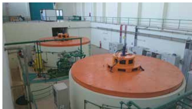
Maschinenhalle mit Generatoren
