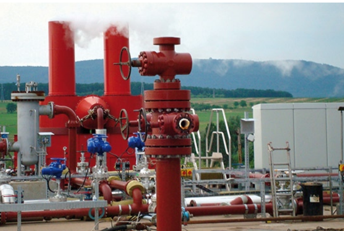
Geothermiekraftwerk in Soultz: Injektionspumpe Quelle: www.soultz.net
